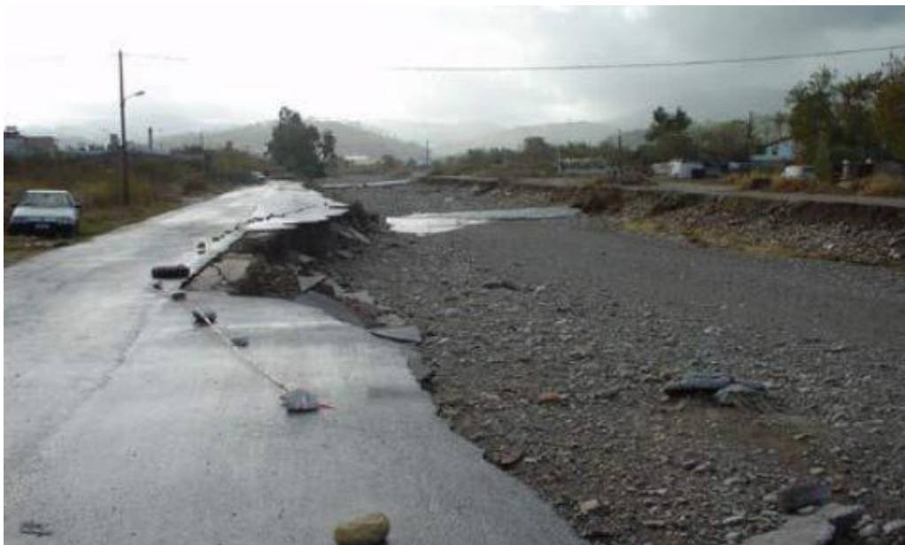
Σχ. 1.8 Διάβρωση στα πρανή κατά μήκος του ρέματος από το πλημμυρικό φαινόμενο του 2001 (Πηγή: Διεύθυνση Γεωργίας Νομαρχιακής Αυτοδιοίκησης Σάμου)
